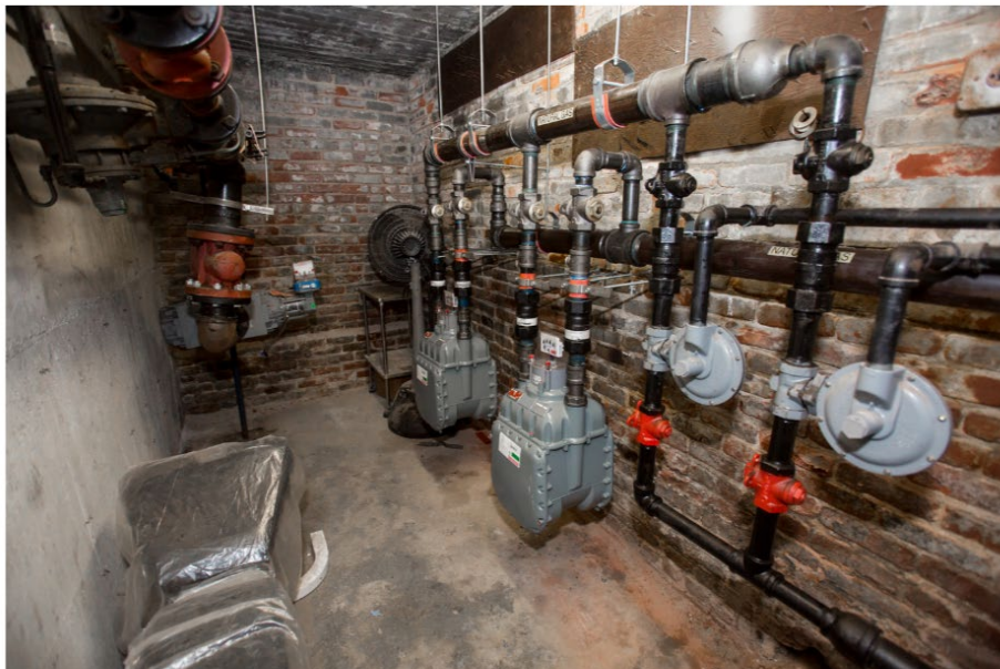
Gas meter room »
